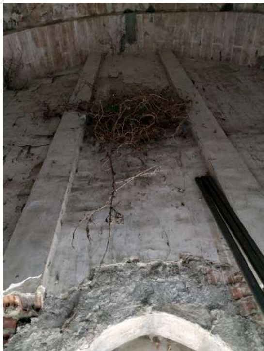
Fig. 00.- Cerramiento oeste de ladrillo hueco y mortero de cemento, con el óculo tupido de vegetación y la clave del arco de portada remontado. Fuente: Aida López
