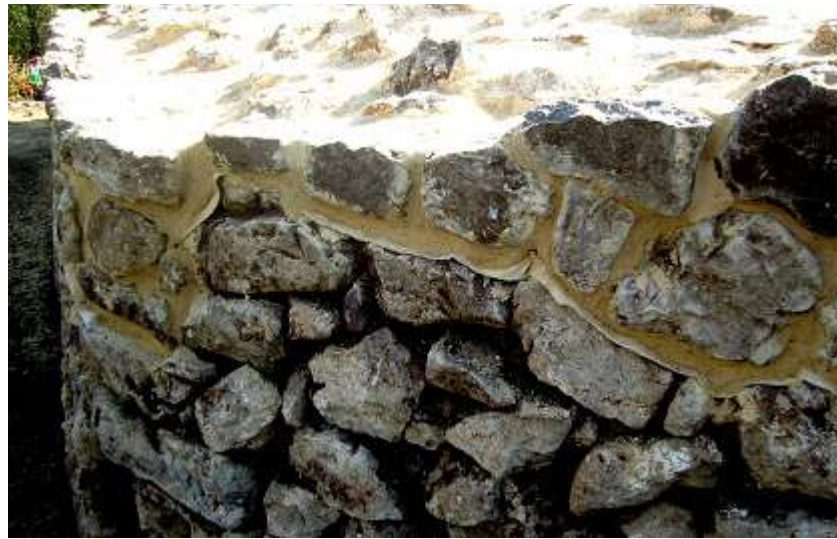
Fig. 00. Separación de obra nueva y preexistencias mediante doble lámina de geotextil, en San Miguel de Ereñozar (fuente: foto Ander de la Fuente)
