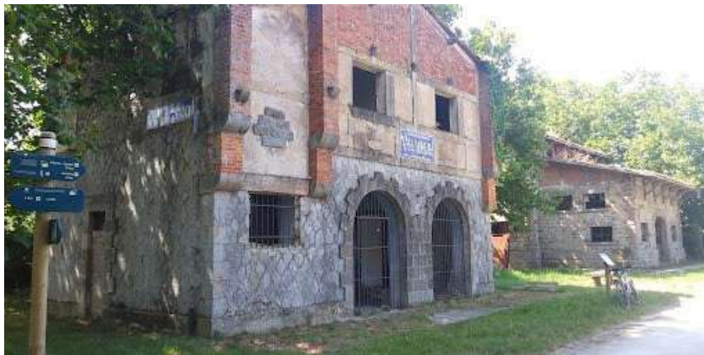
Fig. 00. Estado actual de la estación de Villarreal. La de Urbina es hoy una vivienda privada (fuente: https://horadesalir.com/arratzua-ubarrundia/c-chij-78v5t-ftw0rh0uu0f9hesq )
