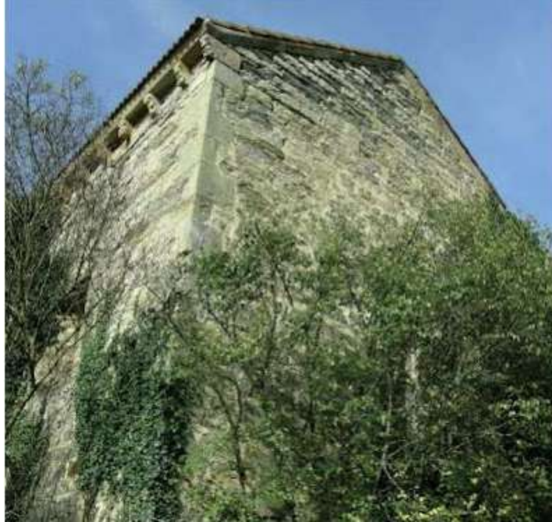
Fig. 00.- La cabecera de la iglesia de Santa Ana de Goiaín cuando comenzaba a ser ocultada por la vegetación. Fuente: Ibon Sáenz de Olazagoitia
